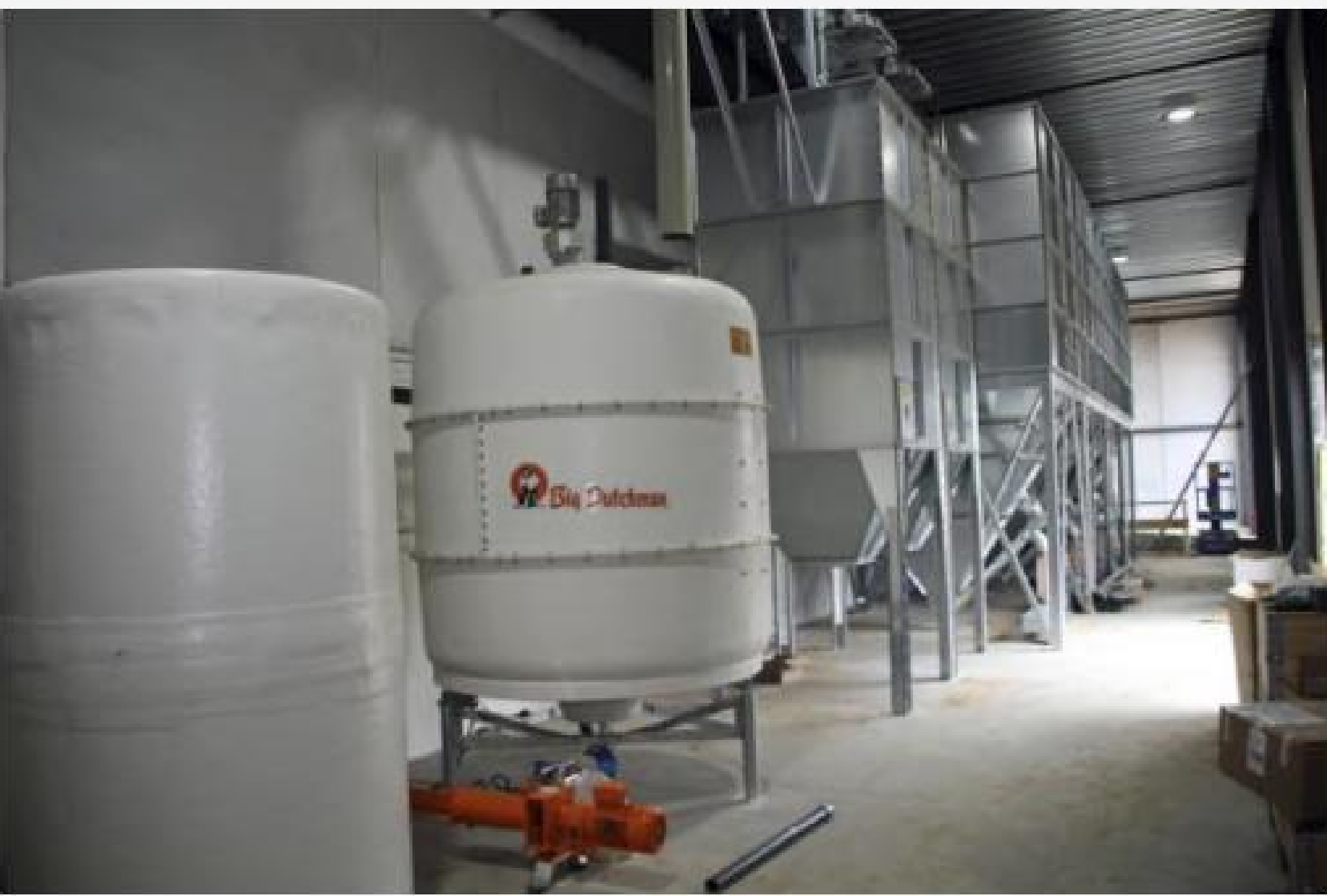
Die Höhe des neuerStalls erleichtert die Einrichtung des Futterstalls. Hier ist der Big Dutchman verantwortlich für die Fütterlösung.
